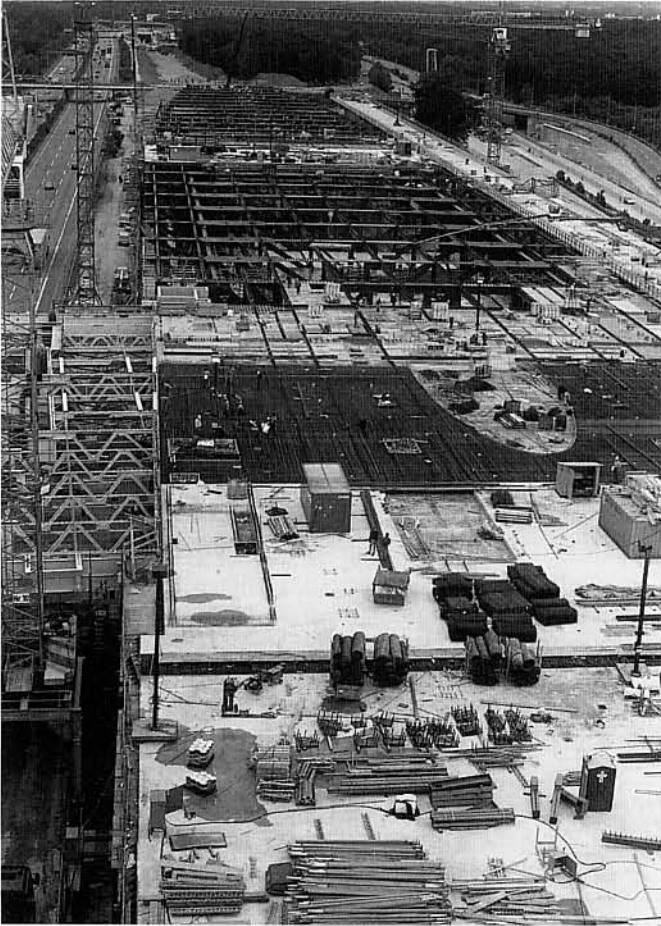
Bild 10. Blick auf die Baustelle (Foto B & SC) Fig. 10. View of the building site
